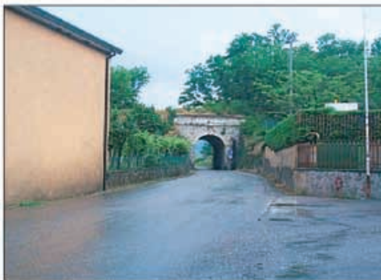
a) Valle Stoffalato a Roncà (VR). Il torrente scorre sopra il ponte.
