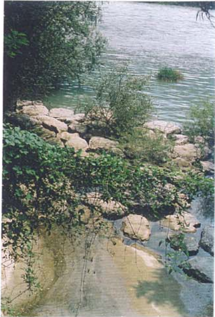
Particolare della riva, artificializzata con scogliere non cementate e rinaturalizzata per riforestazione, e del punto di immissione del canale idroelettrico.
