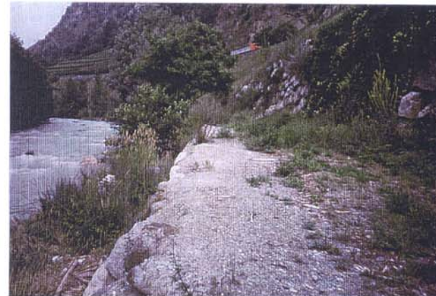
Visione dell'ADR. Si distinguono l'alveo, la riva artificializzata mediante scogliere non cementate e la strada provinciale sovrastante.
